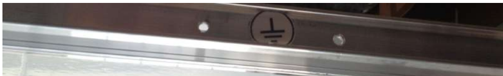
Figura 4-24: fori per connessione al collegamento equipotenziale
